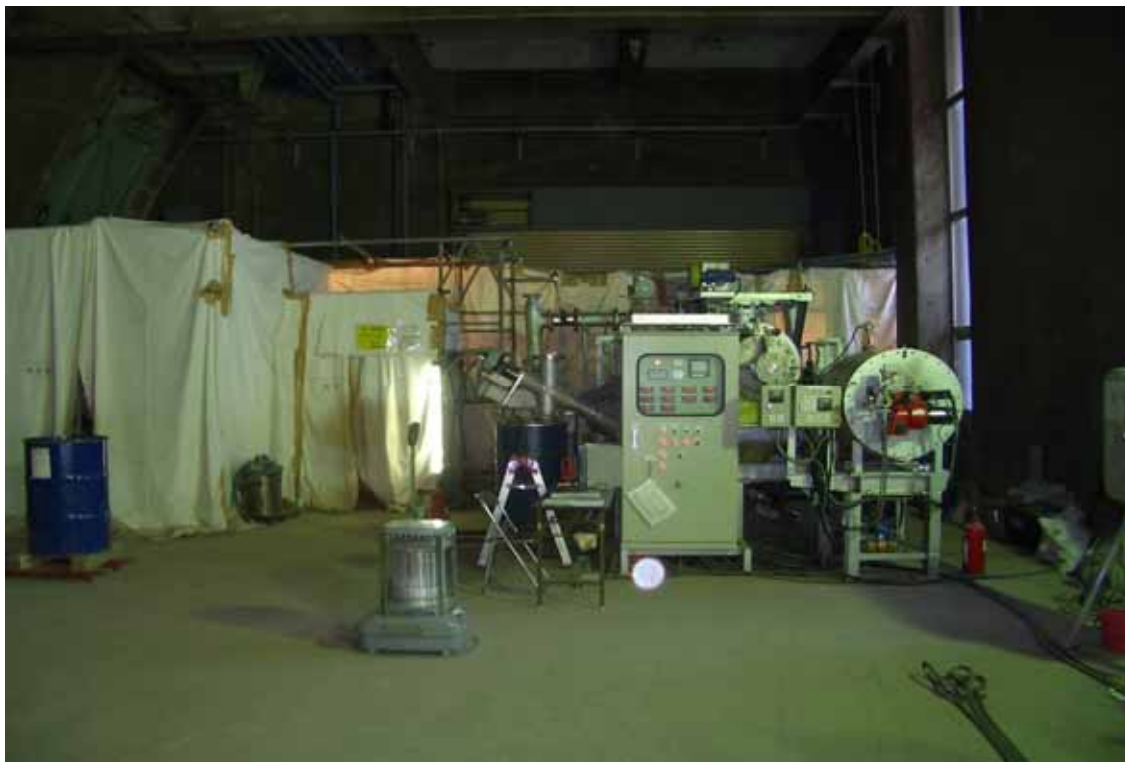
写真：無害化プラント（香川県高松市）
